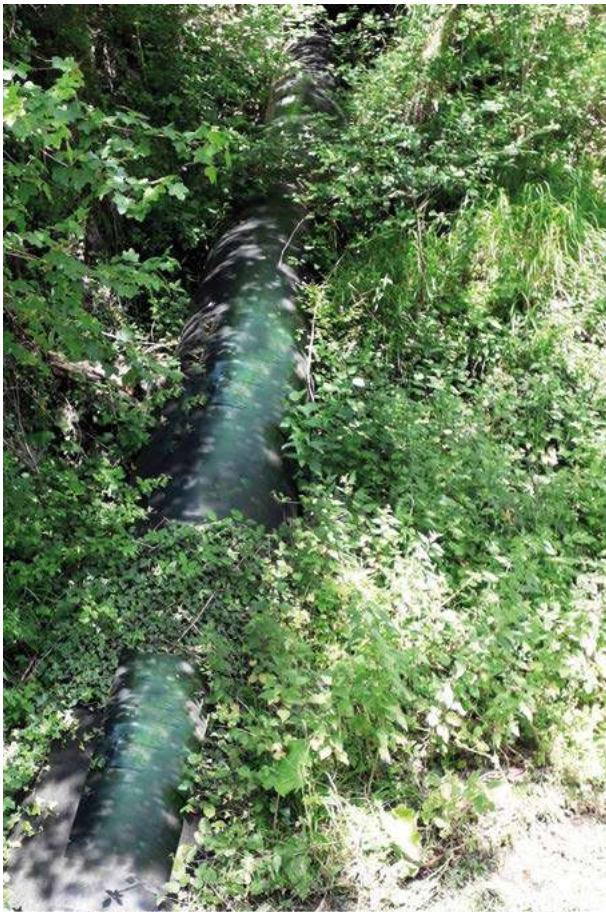
Uno de los dos gruesos tubos que bajan el agua del depósito de arriba a la Central de Arkaka
